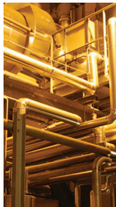
Le circuit vapeur de l'UVETD permet le transport de la vapeur qui servira à la production d'énergie.
